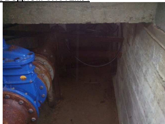
Оштећени мерач протока на ПППВ
